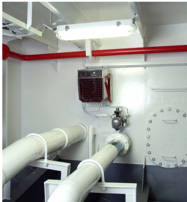
Vibrationen an Bord von Schiffen und Hochseeplattformen können zu Fehlfunktionen an der elektrischen Ausrüstung führen. Der ELEKTRA-V hält dieser Belastung stand.
